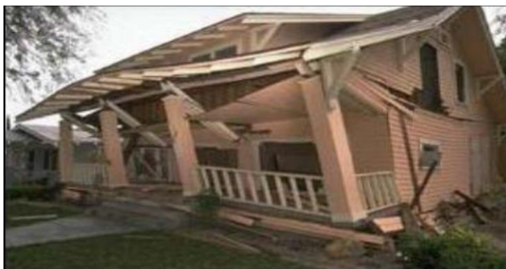
شکل (۲): حرکت سازه بر روی فونداسیون و واژگونی آن
